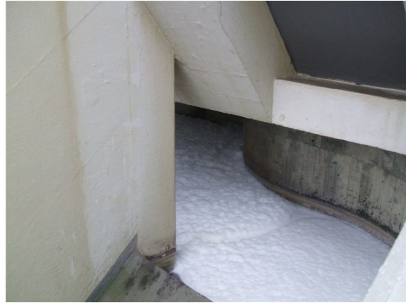
Abb. 6: Schaum im Zulauf der Kläranlage
