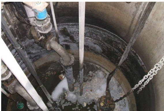
Abb. 21: veraltete Installationen im Pumpenschacht
