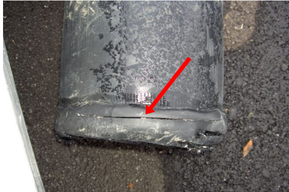
Abb. 23: Teil der Druckleitung PW Rietheim – ARA mit sichtbarem Riss
